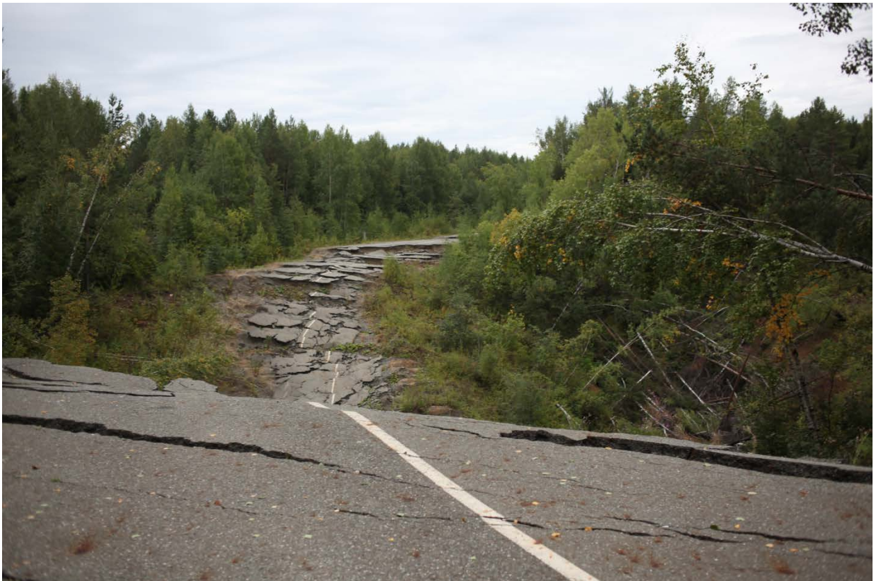
Les galeries de la mine de fer Pestchanskaia (Krasnoturinsk) ont causé l'effondrement de la route.
